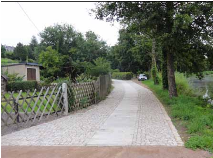
Die Arbeiten an der Befestigung der Straße Am Großteich wurden planmäßig im Juli abgeschlossen.
