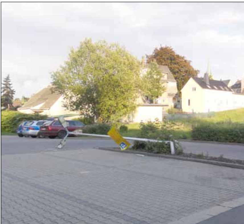
In den frühen Morgenstunden des 10. September 2015 wurde beim Rangieren eines LKW auf dem Parkplatz des NETTO-Marktes die Laterne umgefahren.
