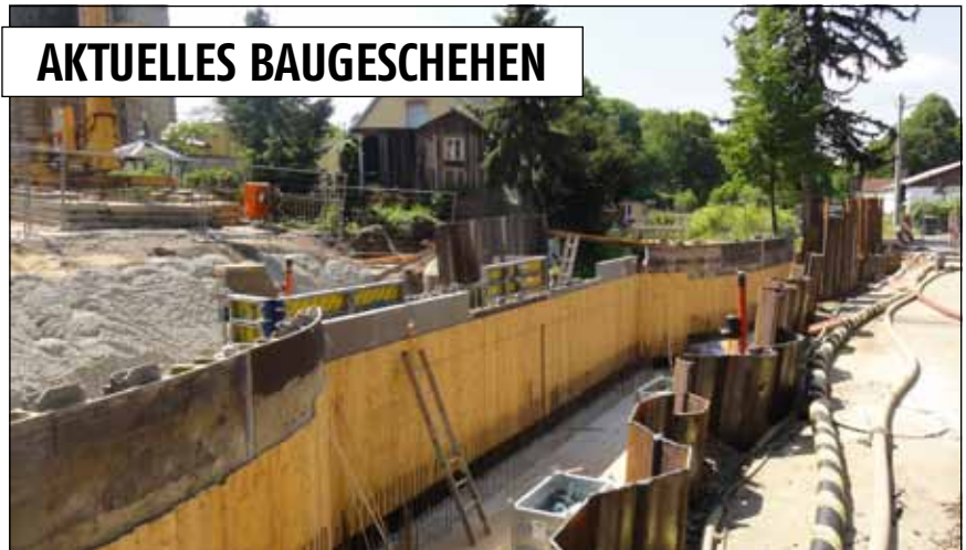
Baufortschritt Brücken-Neubau Gartenstraße: momentan erfolgt der Schalungs- und Bewehrungsbau für die Fundamente und Widerlager
