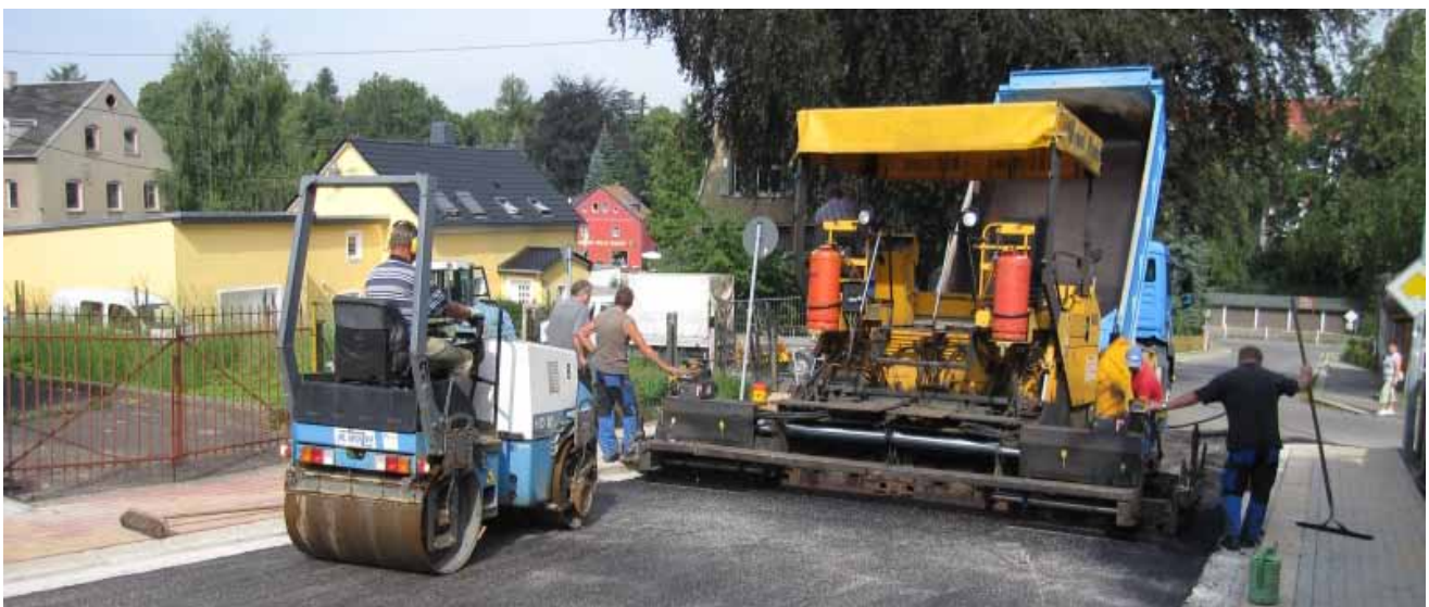
Asphalteinbau an der Gartenstraße - Die Baumaßnahme umfasst die grundsätzliche beidseitige Erneuerung der Gebewege und die Deckensanierung der Fabrbahn.
