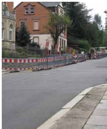
Im Auftrag der envia Verteilernetz GmbH führt Tiefbau Pötschulat Verlegearbeiten in der Bahnhofstr. aus. Im Zuge dieser Arbeiten wird der Fußweg Bahnhofstr. instand gesetzt.
