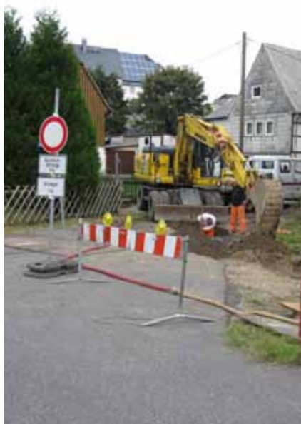
Beginn der Arbeiten zum grundhaften Ausbau der Straße »Am Klosterbach« durch die Delling Bau GmbH.
