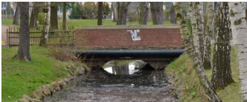
Im Stadtrat diskutiert: Sanierungsvarianten der Brücke Arraser Straße
